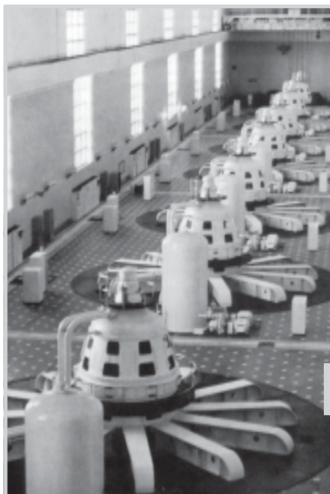
Машинный зал Иркутской ГЭС. Все восемь гидрогенераторов изготовлены новосибирским заводом
